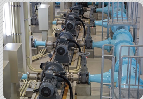
▲新港中央配水場のポンプ
