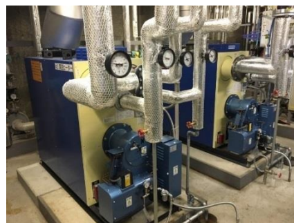
写真：浜益支所の高効率 真空ヒーター
