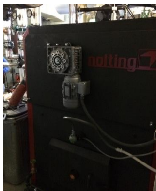
写真：ペレットボイラー
