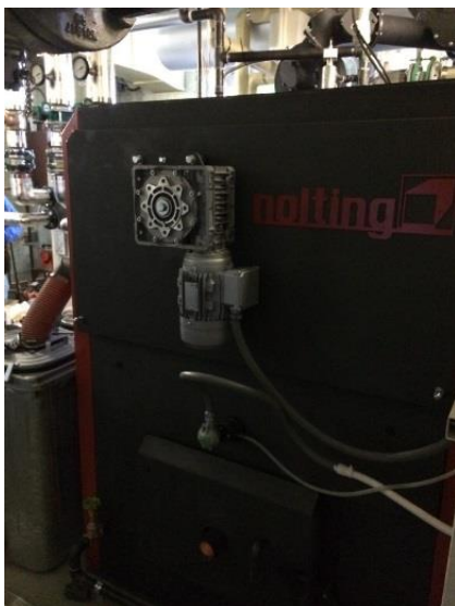
写真：ペレットボイラー
