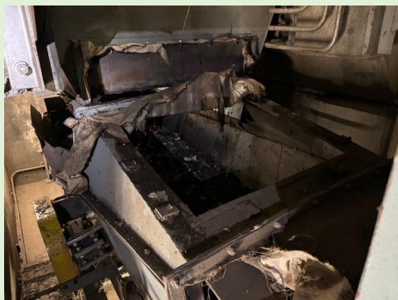
写真：爆発で各種機器が破損している様子
