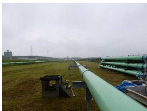
●1 km の超電導ケーブル
