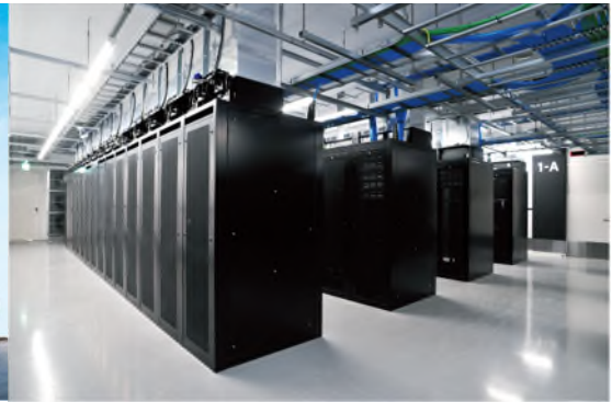
サーバールーム
