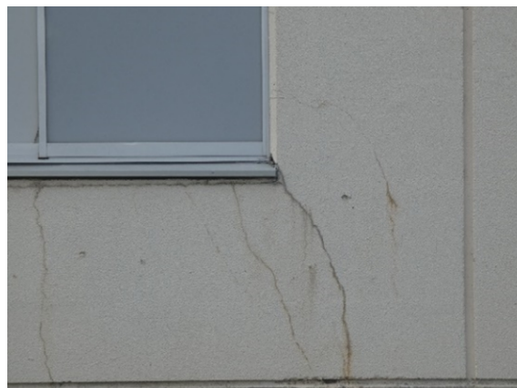
外壁の亀裂〔花川南中〕
