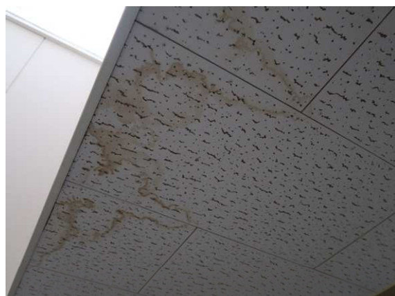
雨水による漏水跡〔生振小〕
