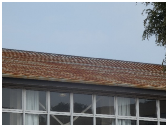
体育館屋根の腐食（錆）〔紅南小〕
