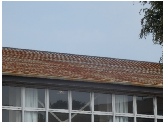
体育館屋根の腐食（錆）〔紅南小〕
