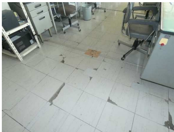
床タイルの剥がれ〔双葉小〕
