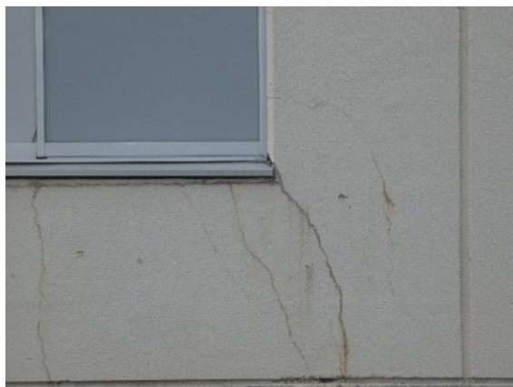
外壁の亀裂〔花川南中〕
