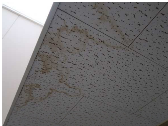
雨水による漏水跡〔生振小〕
