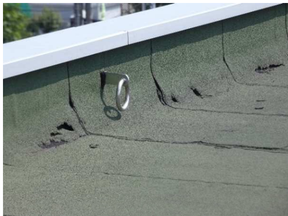
屋上防水シートの劣化〔花川中〕
