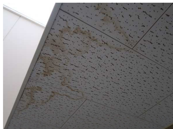
雨水による漏水跡
