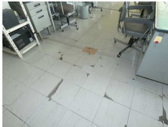
床タイルの剥がれ
