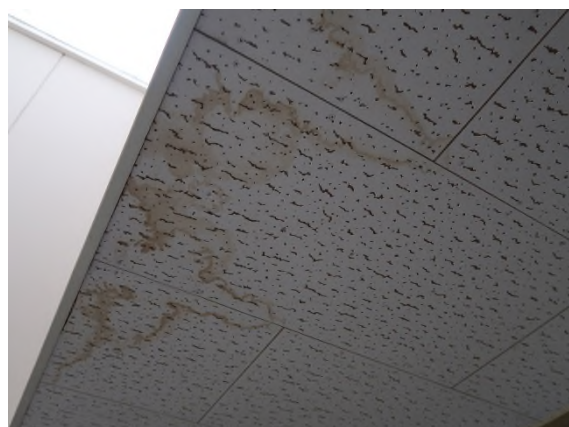
雨水による漏水跡〔生振小〕
