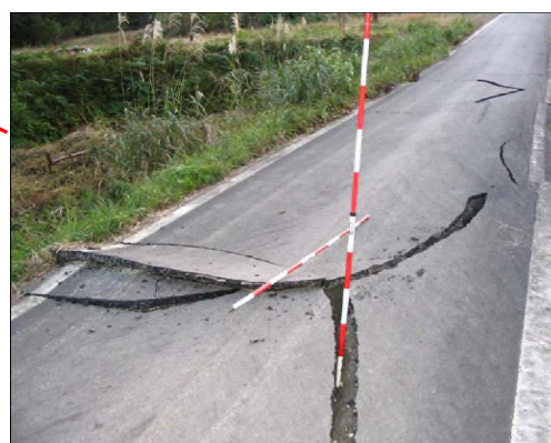
舗装道路のひび
