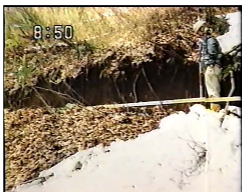
斜面のひびが進行してできた段差
