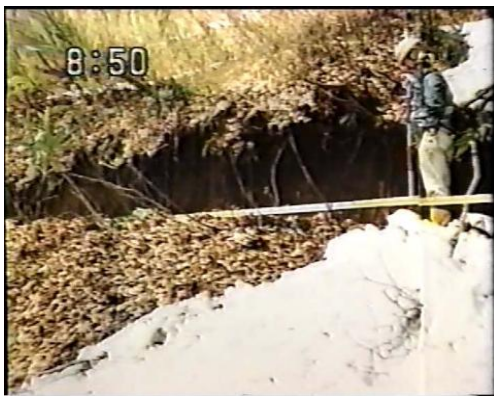
斜面のひびが進行してできた段差
