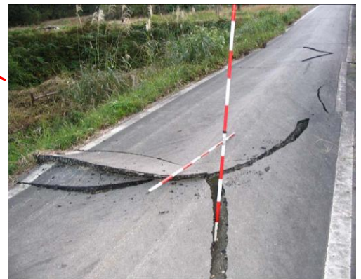
舗装道路のひび
