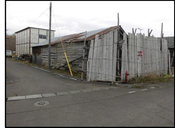
30 厚田区古潭（危険な空家）
