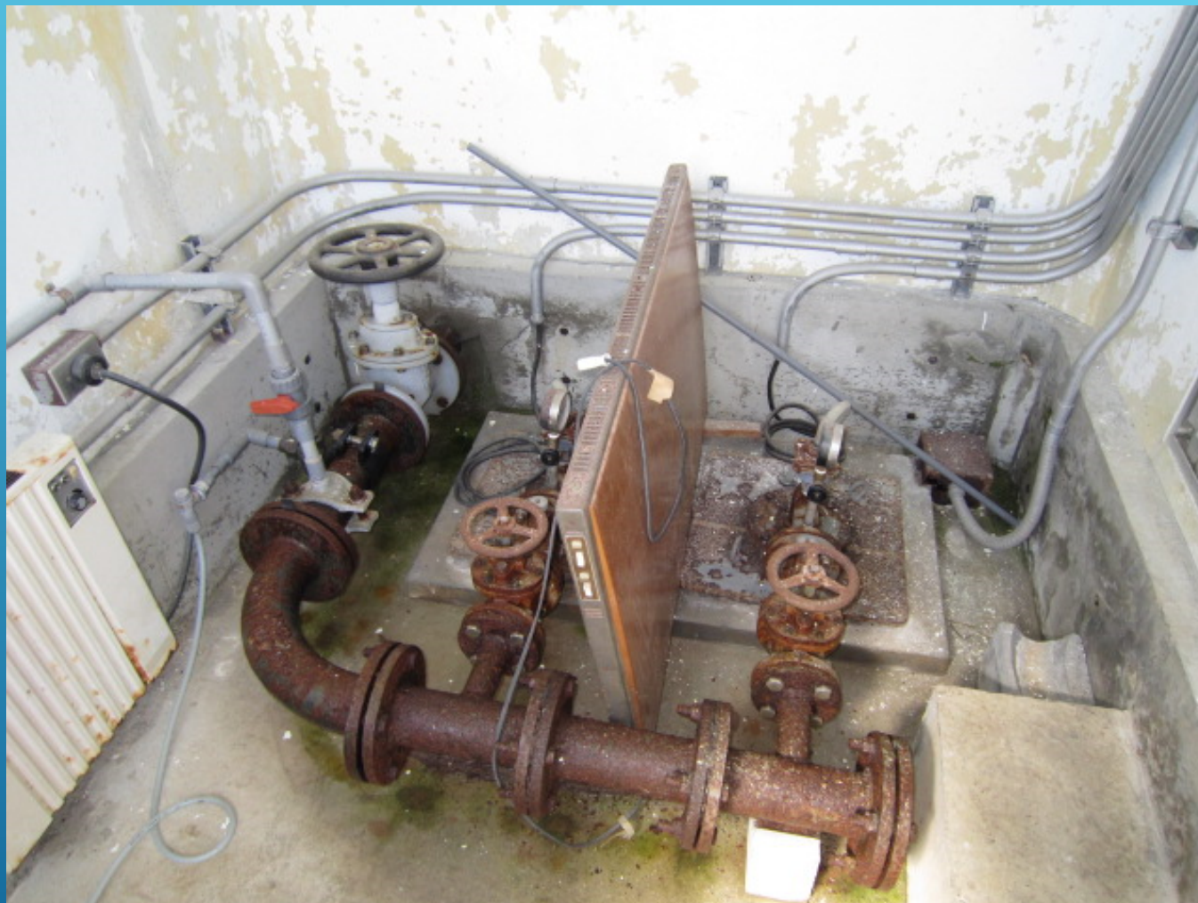
幌送水ポンプ場 場内配管 1971年設置（45年経過）
