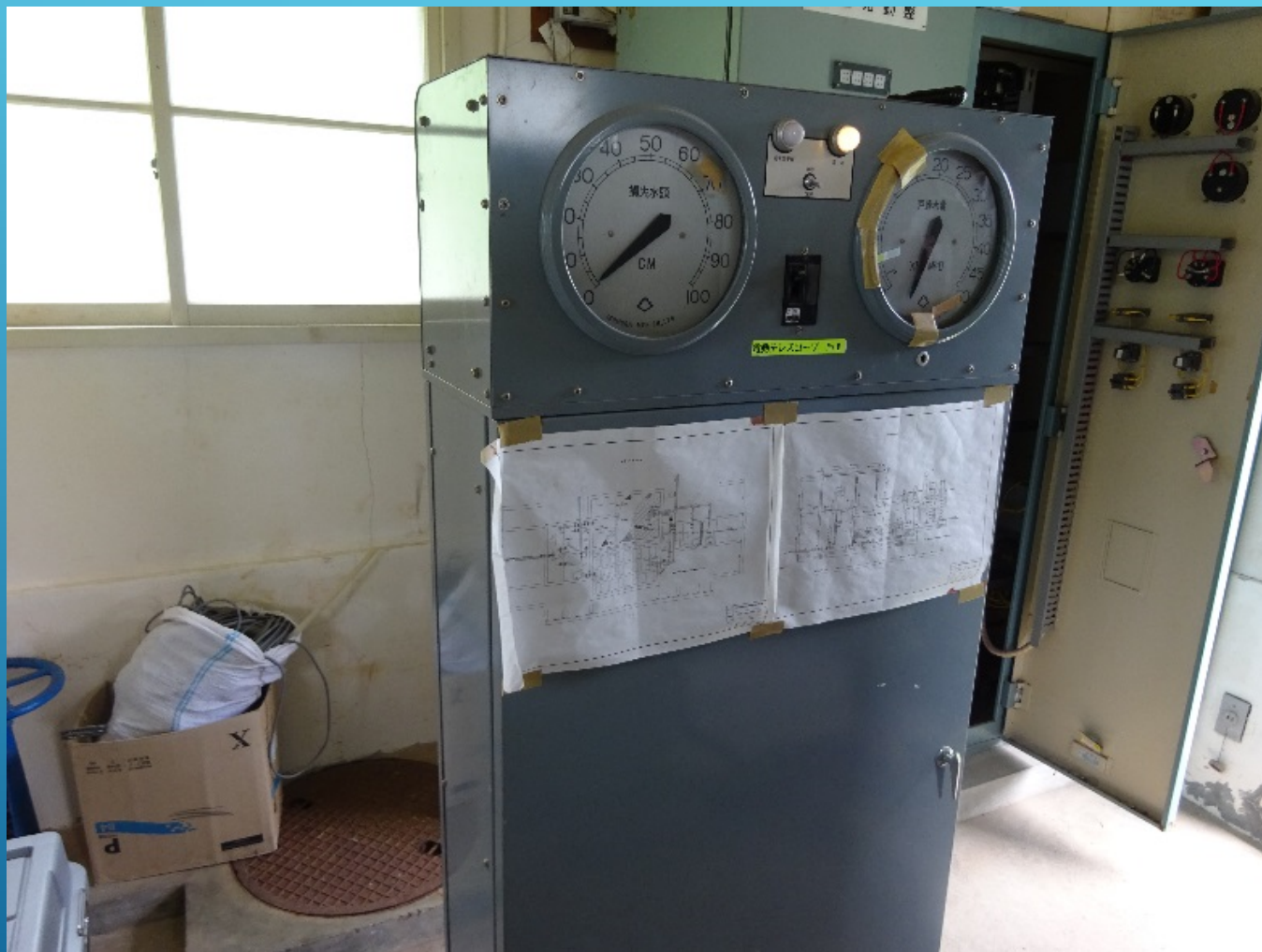
濃昼浄水場テレスコープ 1975年設置（41年経過）
