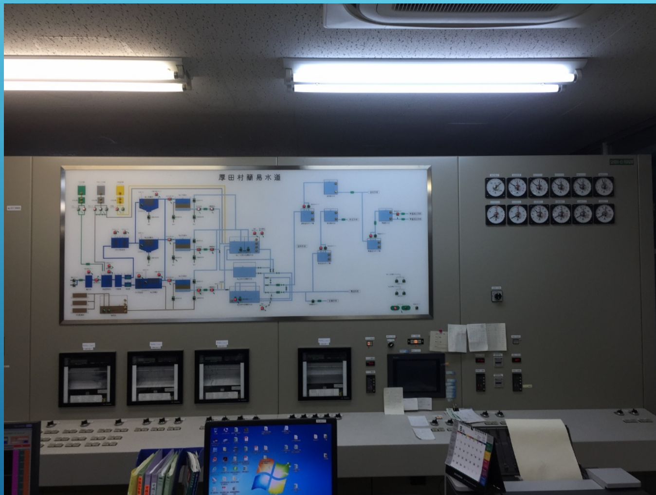
厚田配水場 監視操作盤 1976年設置（40年経過）
