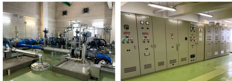
更新された配水ポンプ及び計装盤
