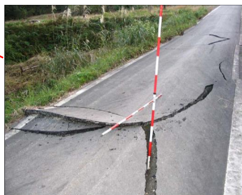
舗装道路のひび
