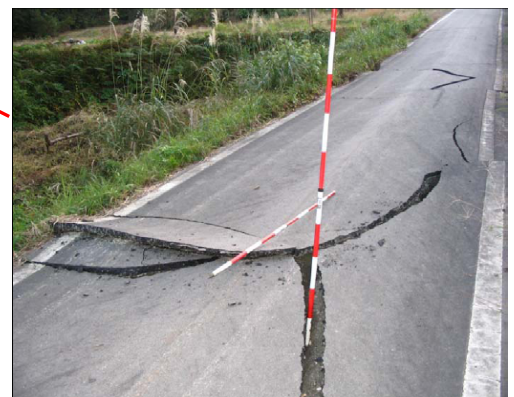
舗装道路のひび
