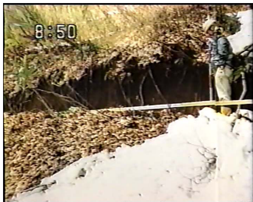
斜面のひびが進行してできた段差
