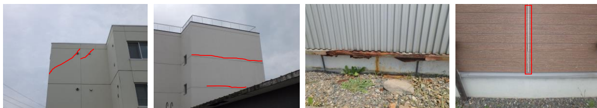
図2 現地調査における劣化状況
