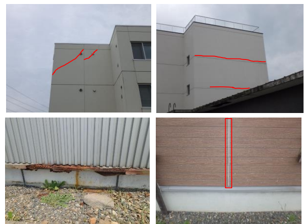
図 4-5 現地調査における劣化状況
