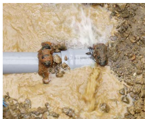
写真-6 管体(漏水)状況（柏木）
