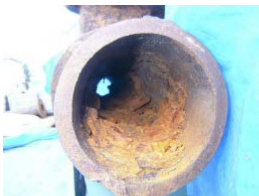
写真-5 管体(内面)状況（花川北）
