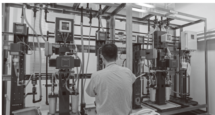
▶新港中央配水場における水質検査の様子
