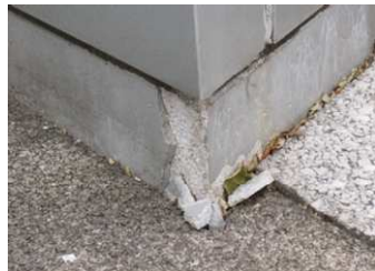
← 図書館基礎モルタル剥離
