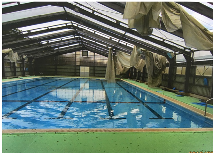
双葉小プール上屋シート破損↑
