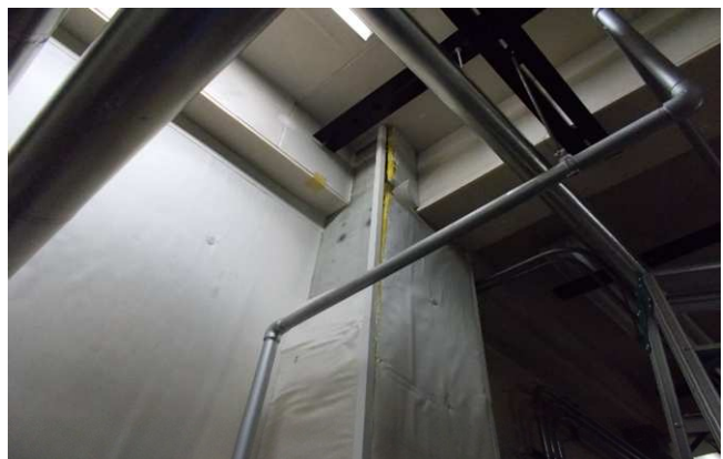
↑ 図書館機械室上部壁面からグラスウールが落下
