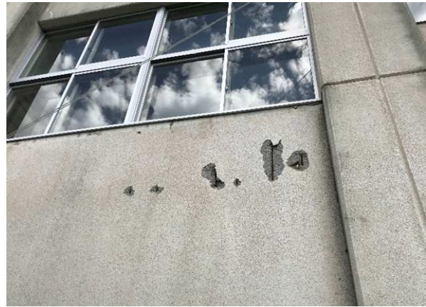
↑ 聚富小中外壁モルタル剥離
