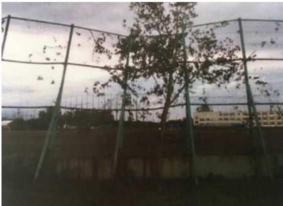
花川南中バドネット破損↑
