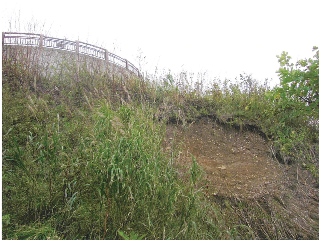
崩れた資料館裏の斜面
