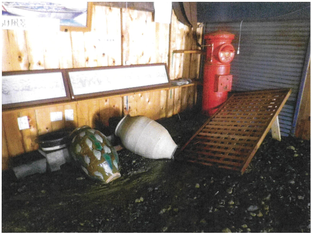
土間に堆積した土砂
