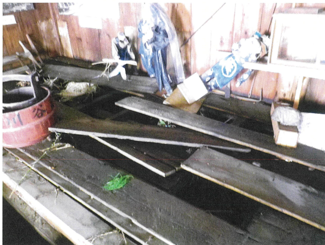
床上浸水で流された床板
