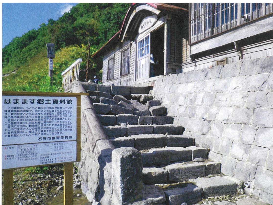
崩れた正面の石段
