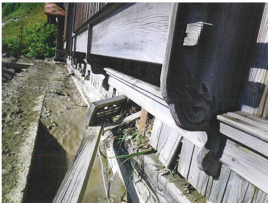
床下から噴出した土砂
