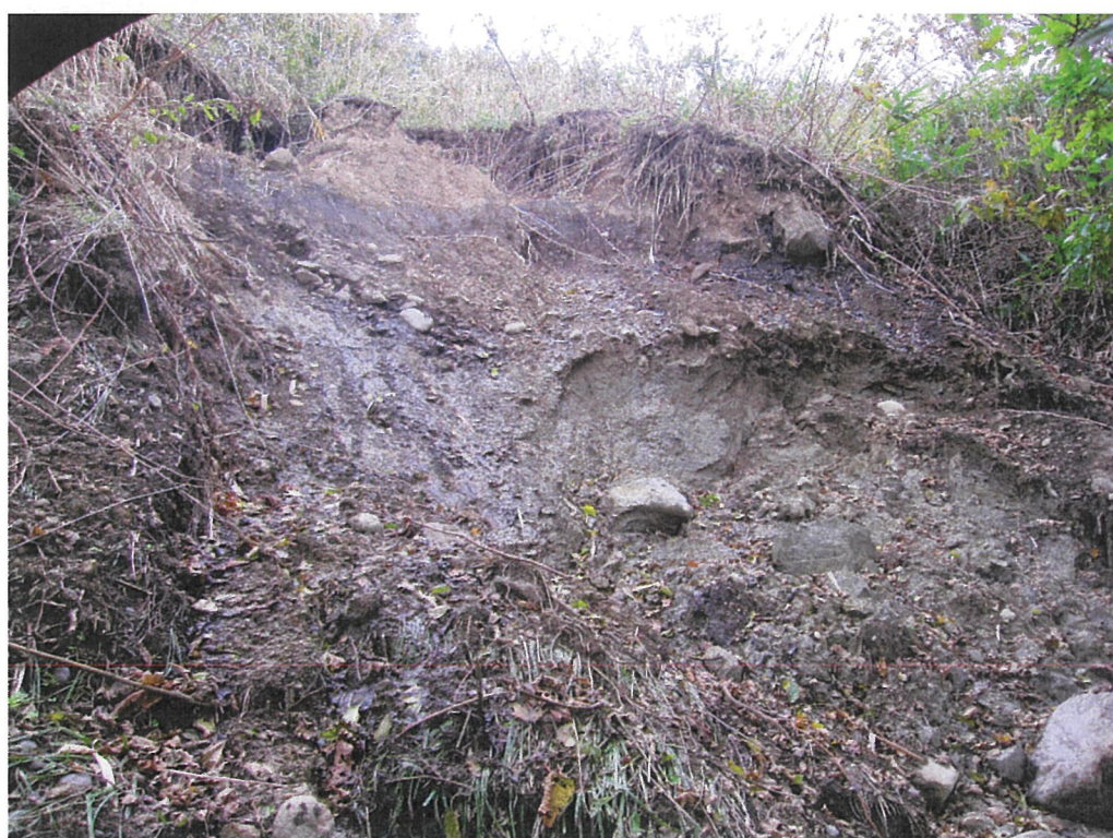
崩れた斜面の状況
