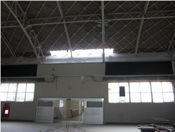
旧浜益中屋体内部から見た状況(発生時)
