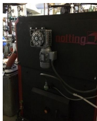
写真：ペレットボイラ
