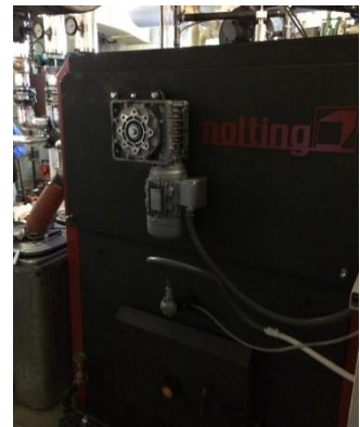
写真：ペレットボイラー
