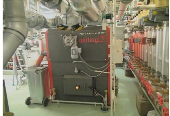
写真：導入したペレットボイラ
