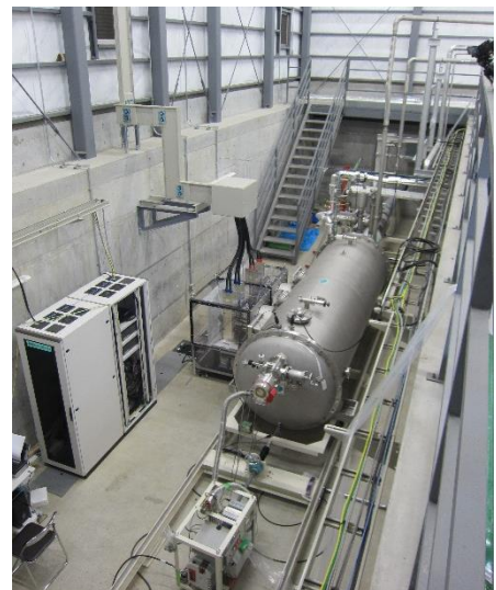
写真：超電導直流送電実証実験装置
