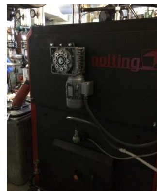
写真：ペレットボイラ
