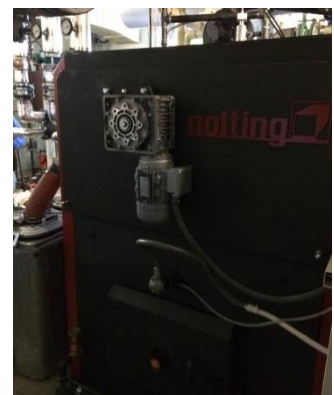
写真：ペレットボイラ
