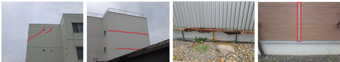
図2 現地調査における劣化状況
