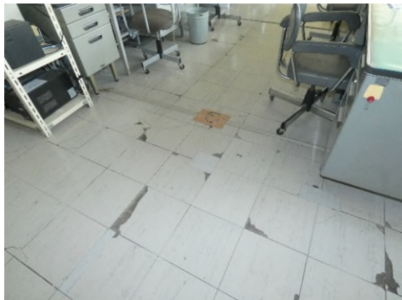
床タイルの剥がれ〔双葉小〕
