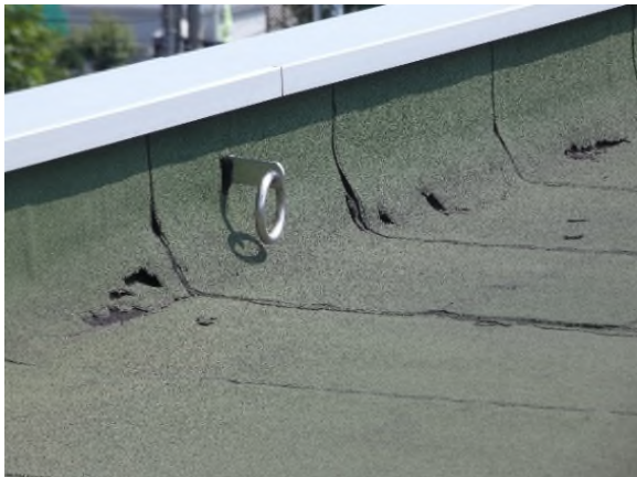
屋上防水シートの劣化〔花川中〕
