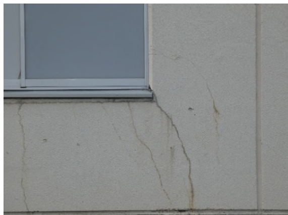
外壁の亀裂〔花川南中〕
