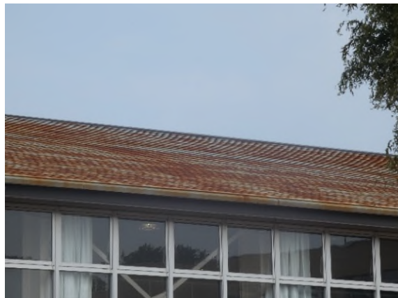
体育館屋根の腐食（錆）〔紅南小〕
