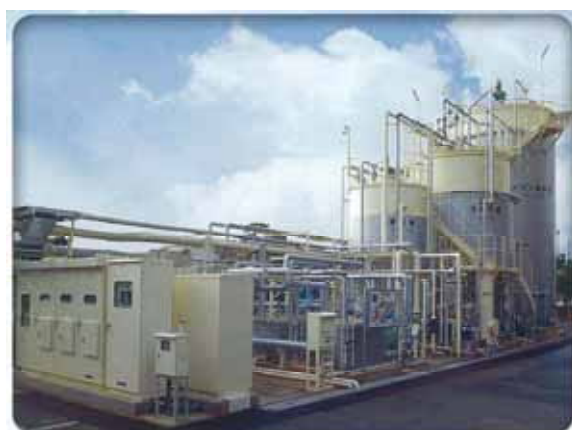
図 5.6 生活協同組合 コープ神戸食品廃棄物処理設備 全景 < 出所 > 生活協同組合コープこうべ「食品廃棄物処理設備 メタン発酵システム(パメディス)」パンフレット
