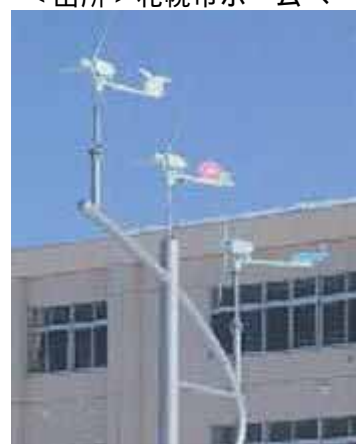
図 5.2 緑苑台小学校3連風車風力発電システム
