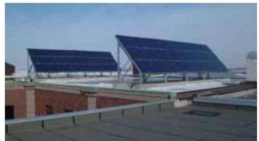
図 2.2 佐藤水産(株)石狩サーモンファクトリー太陽光発電設置状況 < 出所 > 佐藤水産(株)「共同研究項目「佐藤水産(株)石狩サーモンファクトリー太陽光発電フィールドテスト事業」平成13年度共同研究業務成果報告書」
