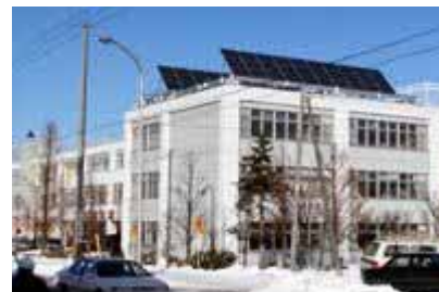
図 5.1 札幌市立美しが丘小学校太陽光発電パネル < 出所 > 札幌市ホームページ
