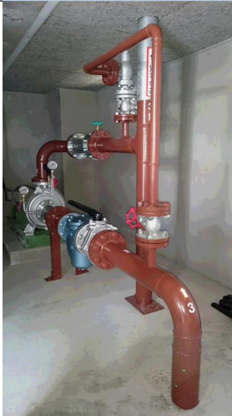
一般取扱所 下層部配管
