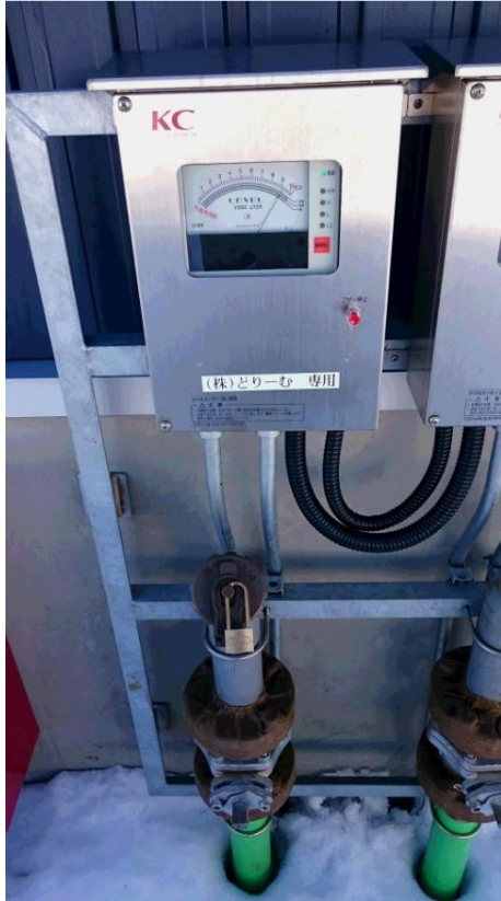
地下タンク 給油口
