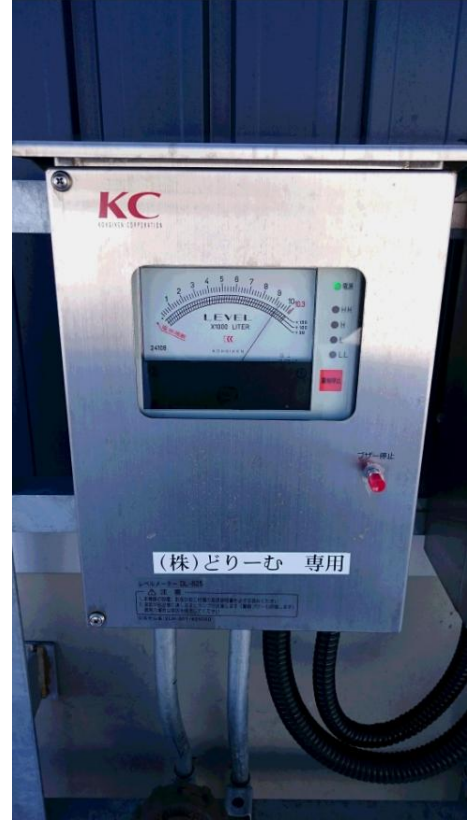
地下タンク メーター
