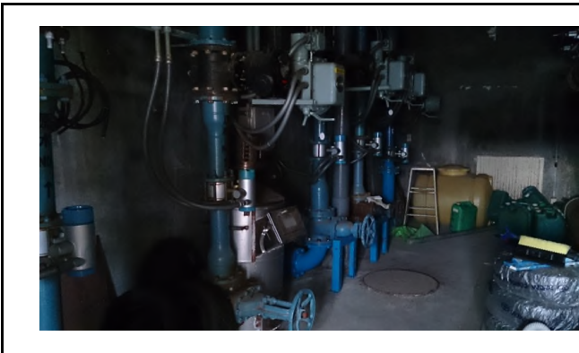
建屋1F(ポンプ室の一部)
