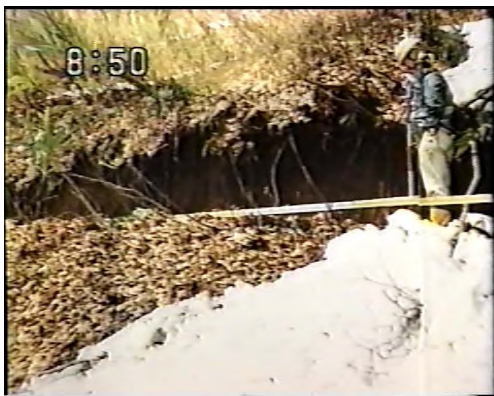
斜面のひびが進行してできた段差
