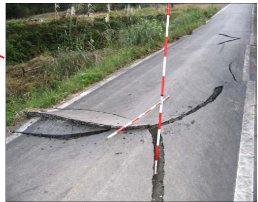
舗装道路のひび
