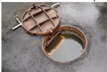
▲雨水が入り込んで満水になった汚水マンホール
