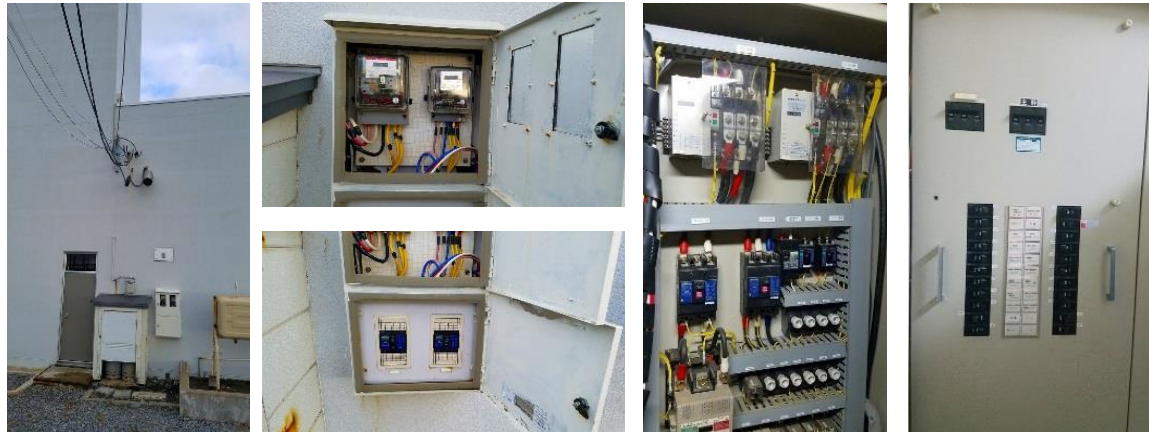
引込開閉器盤状況
